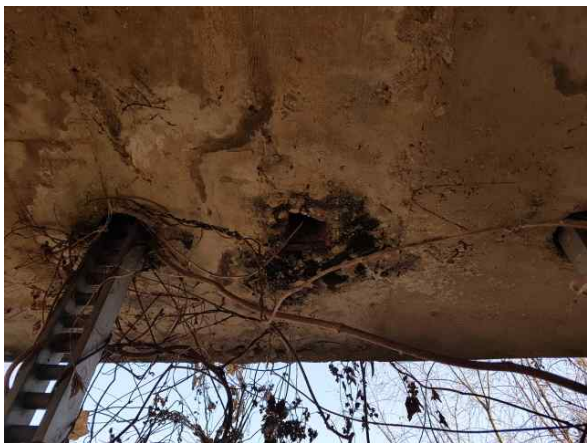
콘크리트 마감불량, 철근노출
