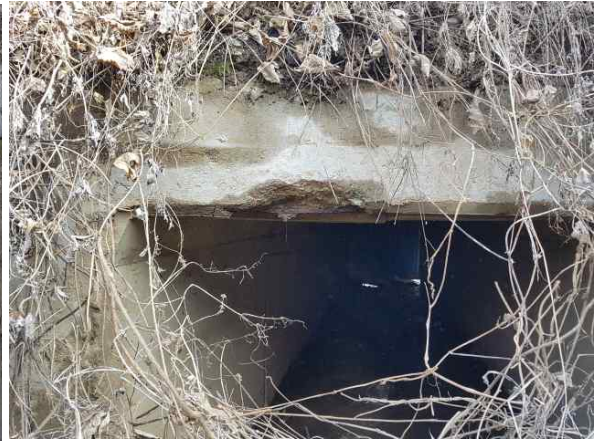
암거 상면 콘크리트 탈락, 철근부식
