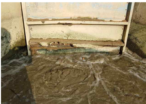
Flab문짝 보강재 파손
