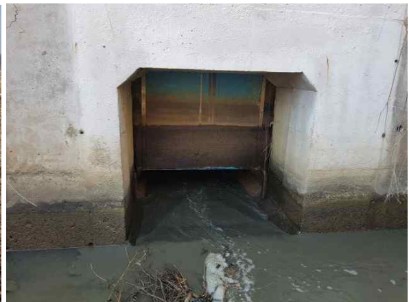
권양기 작동상태 양호
